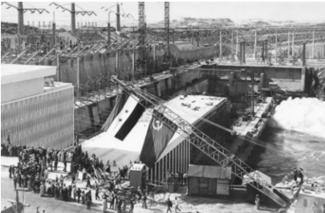
3.8 > Als technische Meisterleistung feierte man den Assuan-Staudamm bei seiner Inbetriebnahme 1968. Von den Umweltproblemen wie etwa der Versalzung der Küste ahnte man damals noch nichts. 1971 wurde der Staudamm dann offiziell eröffnet. Die Bauarbeiten hatten rund elf Jahre gedauert.
